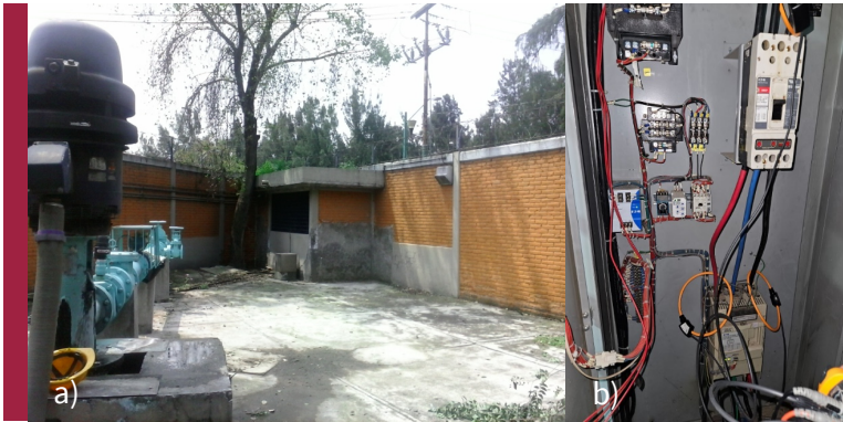
Figura 43. a) Imagen del pozo Alameda de Tacubaya y b) del gabinete de control.
