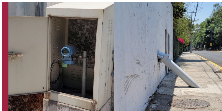
Figura 14. Medidor de flujo e imagen de la calle donde pasa la tubería y debe encontrarse el sensor.
