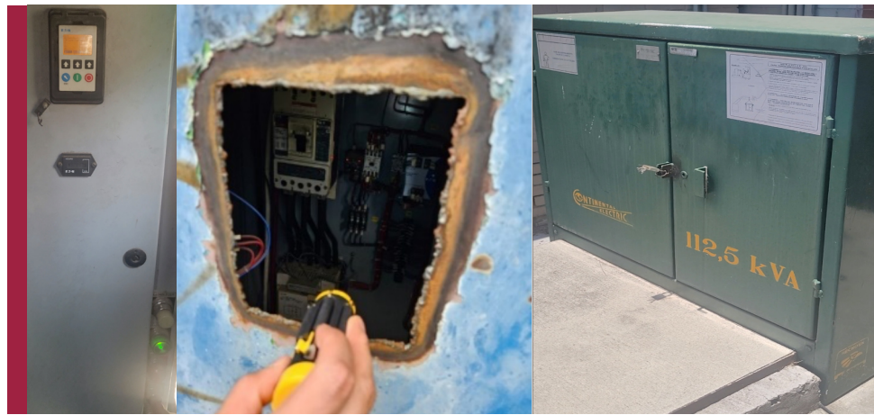
Figura 22. Arrancador E811, protección del gabinete de control y transformador del pozo Directo 25.
