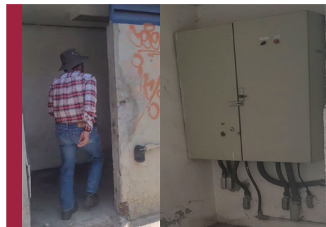
Figura 26. Caseta del sistema de telemetría del pozo Directo 25.
