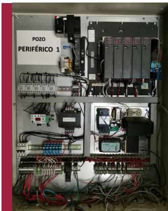
Figura 4. Sistema de telemetría del pozo Periférico 1.
