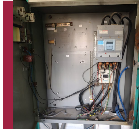
Figura 28. Gabinete de control del pozo Deportivo Durango.
