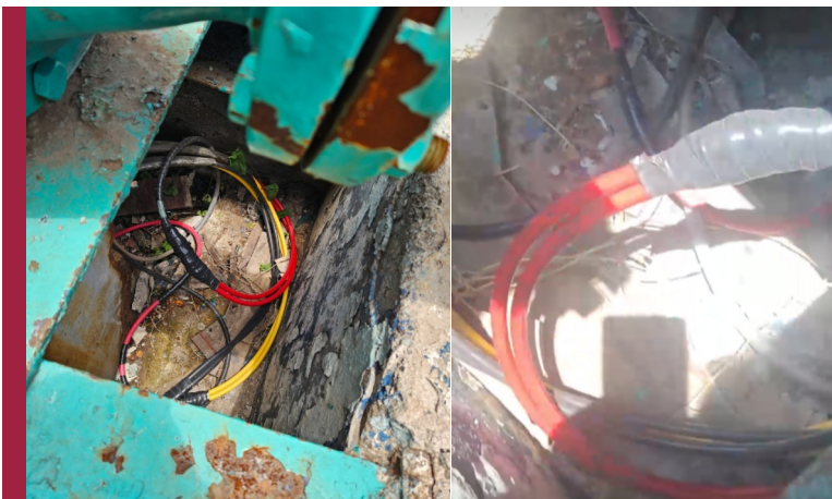
Figura 23. Imagen de los cables de conexión a las bombas en el pozo Directo 25.
