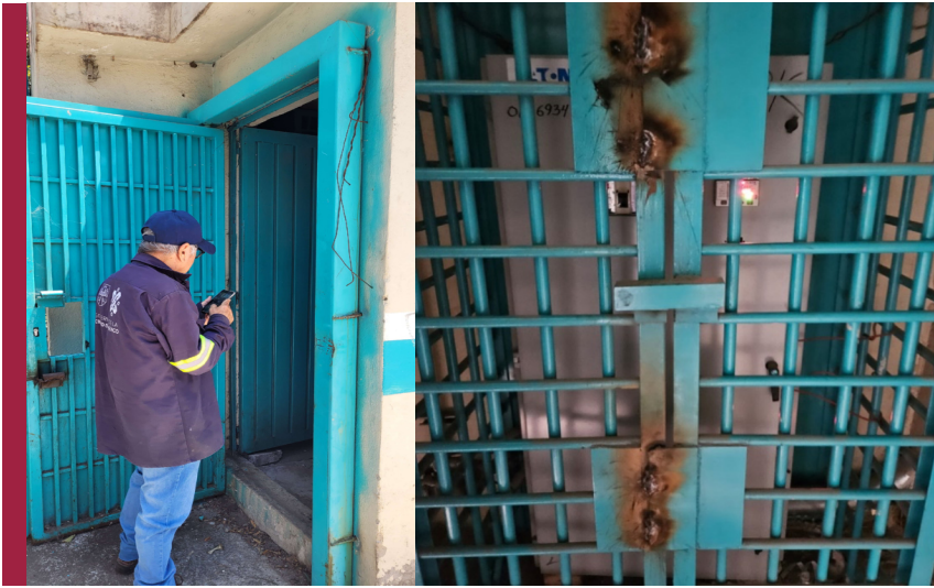
Figura 32. Puerta de seguridad de la caseta de control y gabinete de control del pozo Casa Amarilla.
