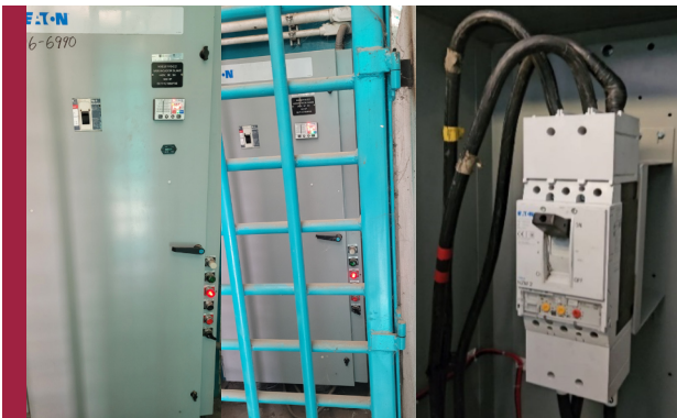
Figura 36. Imágenes de la caseta de control y del interruptor en el pozo Antonio M. Anza.
