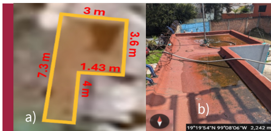
Figura 12. a) Medidas del perímetro y b) foto actual del estado del techo en el pozo Auxiliar Xotepingo 1C.
